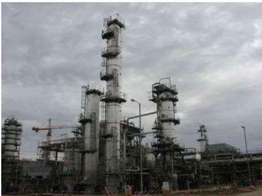
Karachaganak 1993 L'impianto per il trattamento gas costruito dai Russi
